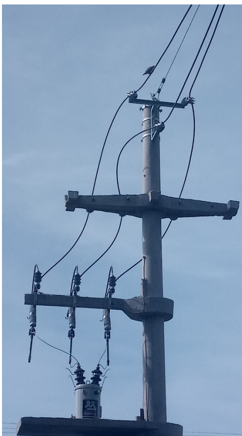
Figura 9, Subestación monofásica alimentada por cable protegido.
