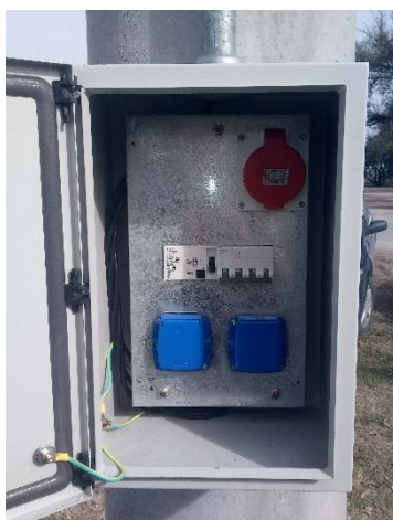
Figura 10, Tablero de baja tensión.
