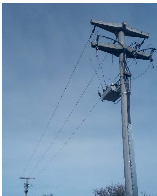
Figura 7, Punto de arranque de la línea aérea.
