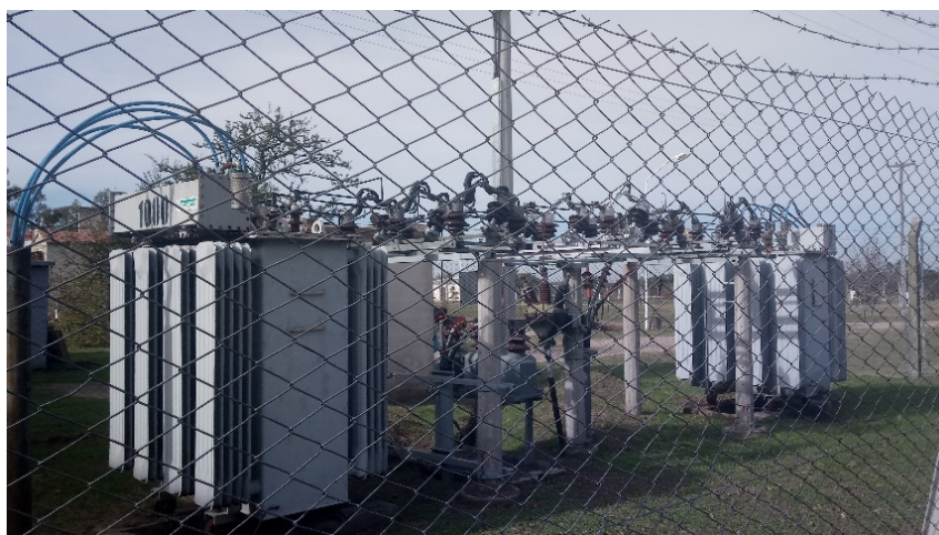
Figura 6, Vista de la subestación de 2 MVA.
