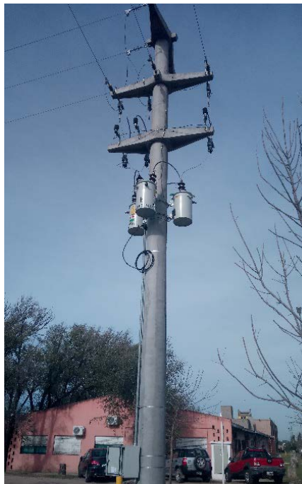
Figura 8, Subestación de carga y creación de neutro.
