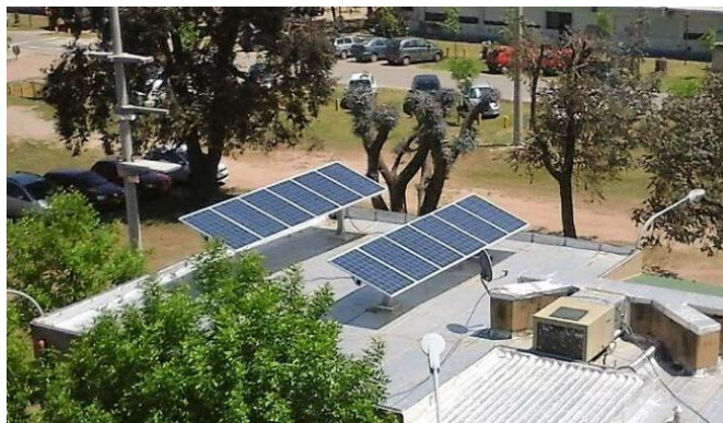
Figura 5, Paneles fotovoltaicos de 3 kWp.
