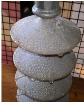
Figura 2: Línea El Sauzal-Algarrobo del Águila – Piquete N° 45 – Fase 2 – Aletas 1, 2, y 3. Fuente: Elaboración propia.
