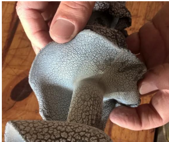
Figura 5: Inspección Aislador – Línea Mauricio Mayer-Eduardo Castex – Piquete 93 – Fase 2. Fuente: Elaboración propia.
