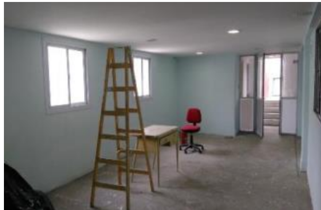
Figura 17. Adecuación edilicia con pintura acorde para cámaras IR Fuente: elaboración propia
