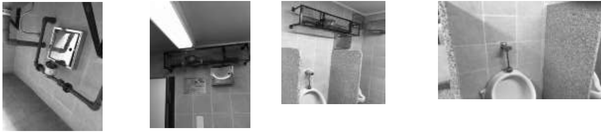
Figura 5: vista de los medidores de caudal de agua, la primera imagen, bajo mesada, la segunda ubicación del mismo en la cañería que abastece los inodoros. Fuente: Elaboración Propia
